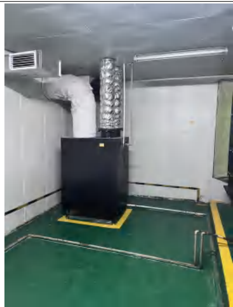
发电机尾气水喷淋设施
